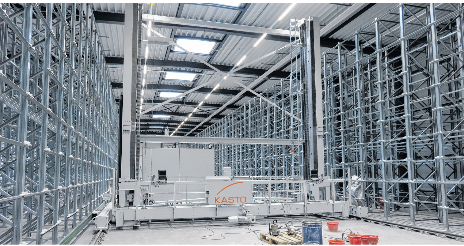
Im Rohrlager wird dieses hochmoderne Regalbediengerät zum Einsatz kommen, das EDV-gesteuert Rohre an ihren Platz befördert beziehungsweise zur Auslieferung abholt.
